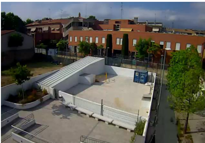
Solar de la segona llar residència del complex de la ciutat de Granollers en el moment d'iniciar-se les obres
