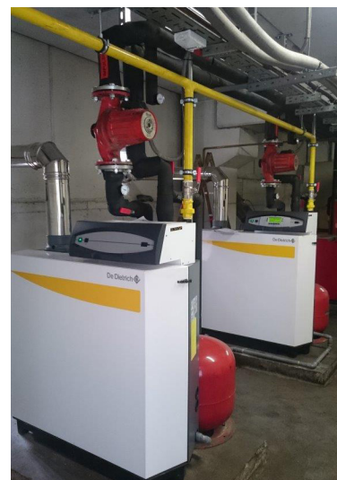
Les noves calderes, més eficients i sostenibles
